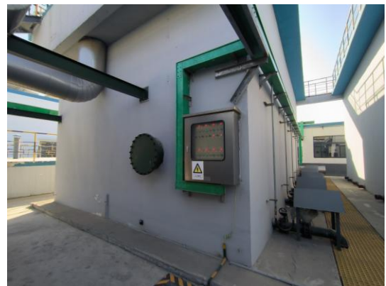
综合絮凝沉淀池
